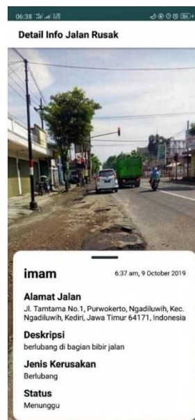
Gambar 10. Tampilan Detail Informasi Jalan Rusak
